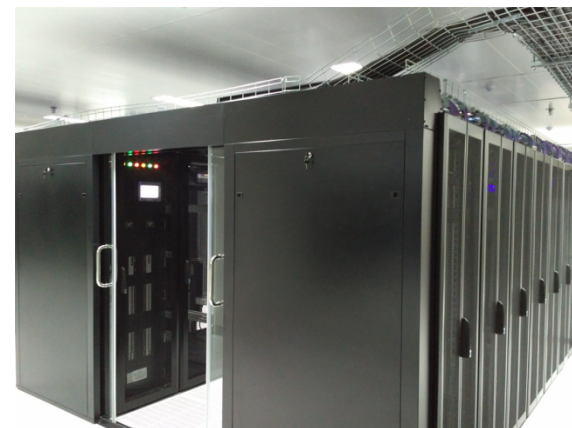
冷通道机柜池
